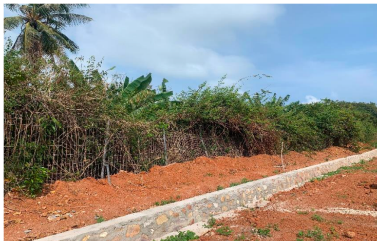
Gambar 4. Pagar Perimeter yang Roboh di Sisi Kanan Runway 13
