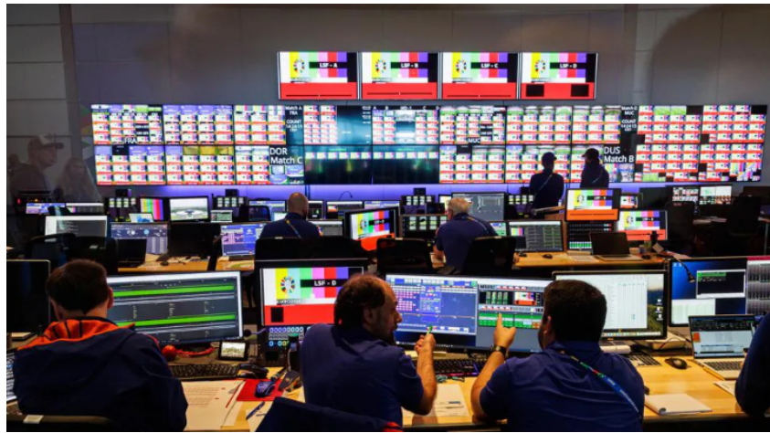
Gambar 1. Ruang kontrol utama di Pusat Penyiaran Internasional di Leipzig, Jerman
