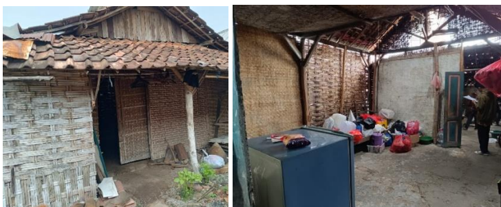
Gambar 3.3 Bangunan Rumah Masyarakat Miskin Sebelum Rutilahu Sumber: Arsip Seksi Ketentraman Ketertiban Umum dan Pembangunan Made
