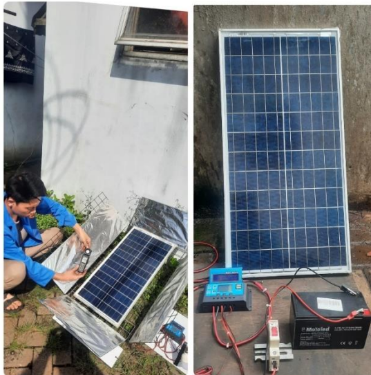
Gambar 3. Pengujian panel surya
