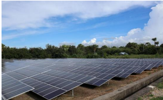
Gambar 1. Pembangkit Listrik Tenaga Surya
