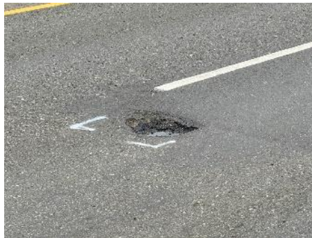
Gambar 1. Contoh Kerusakan Jalan (Lubang) pada ruas Jalan Tol Palikanci
